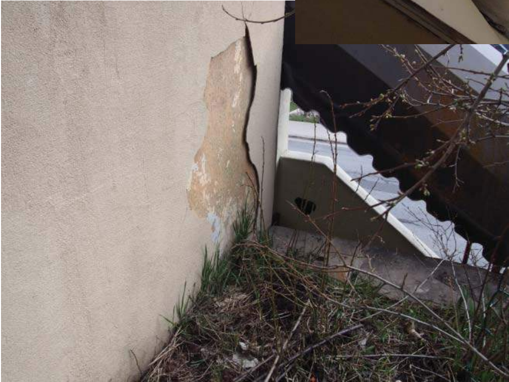
33 - SE Wall Stucco Peel
